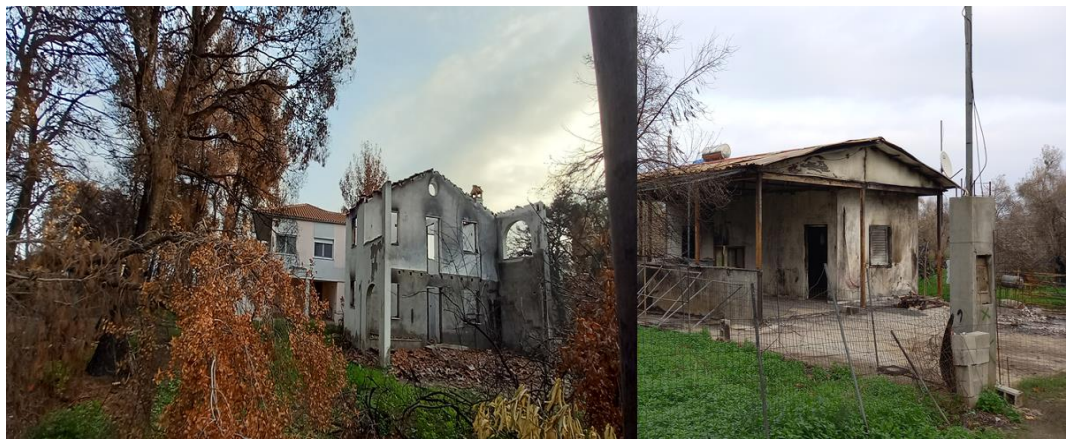
Σχήμα 2. Κατοικίες με σημαντικές ζημιές εξαιτίας της παλαιότητάς τους ή των υλικών κατασκευής τους Figure 2. Houses with significant damage due to pure or aged construction materials
